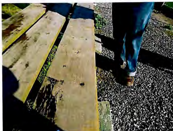
Fotografía N°4: Detalle del estado de los tablonces de las graderías.
