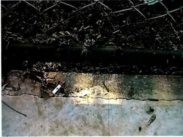
Fotografía N°16: Detalle del estado de reja metálica.
