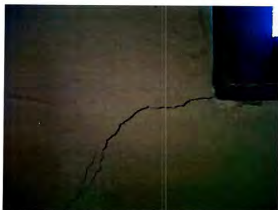
Fotografía N°45: Vista de fisura al interior del recinto.
