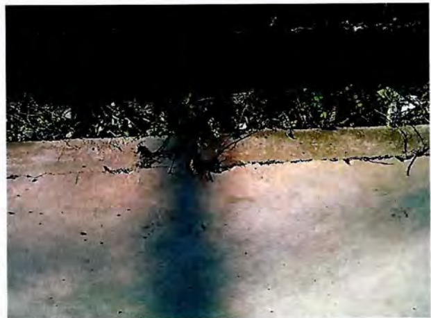
Fotografía N° 17: Vista de uno de los sectores que presenta lo objetado.
