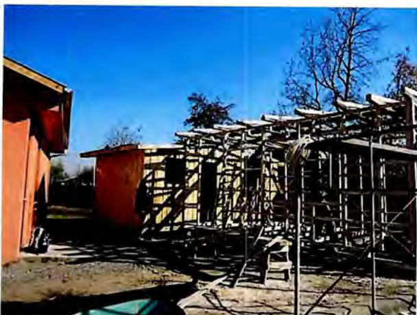
Fotografía N°5: Vista de la obra, que se ejecuta sin el permiso de edificación.
