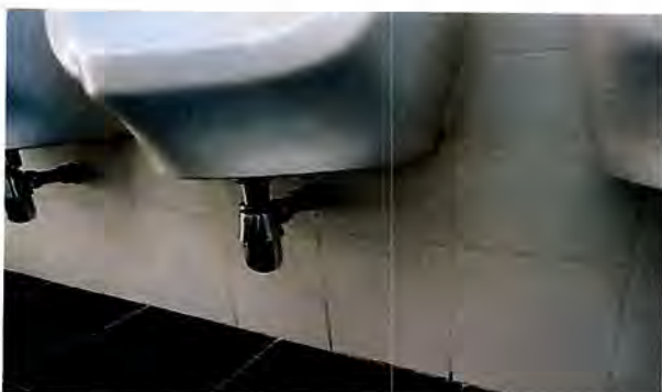
Fotografía N° 1: Vista del artefacto que presenta deficiente sellado en su descarga.
