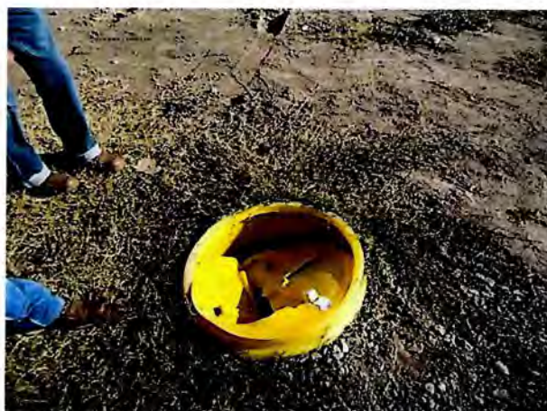
Fotografía N°6: Detalle de tapa de cámara dañada.
