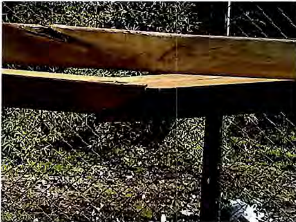
Fotografía N°30: Elemento constructivo dañado.
