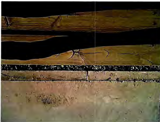
Fotografía N°33: Detalle de piezas de madera con defectos.
