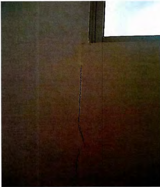
Fotografía N°24 Detalle de fisuras en paramentos verticales.
