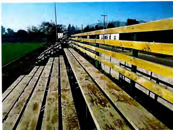
Fotografía N°3: Vista del deterioro prematuro del tratamiento aplicado en tablonces de madera.
