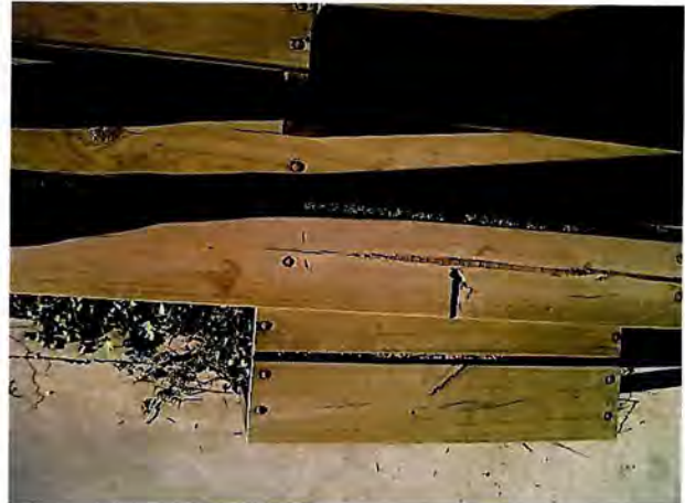
Fotografía N° 32: Vista de la calidad de los elementos empleados en la obra.
