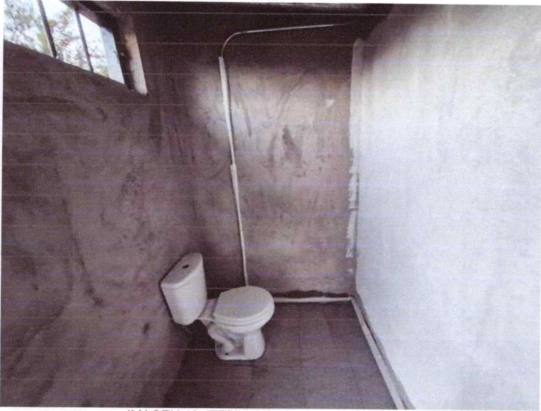
IMAGEN 19: ITEM 4.1.1 WC CON ESTANQUE.
