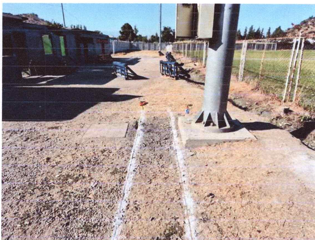
IMAGEN 28:ITEM 4.3 INSTALACION ELECTRICA.
