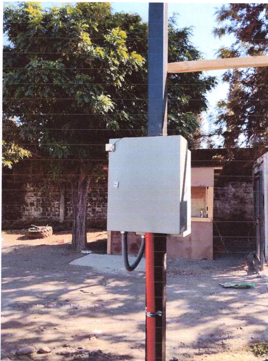
IMAGEN 24:ITEM 4.3 INSTALACION ELECTRICA.
