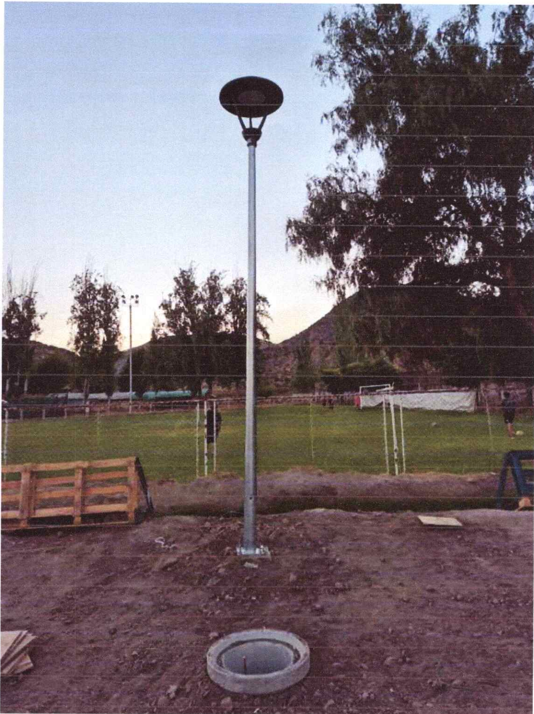
IMAGEN 30:ITEM 4.3 INSTALACION ELECTRICA.
