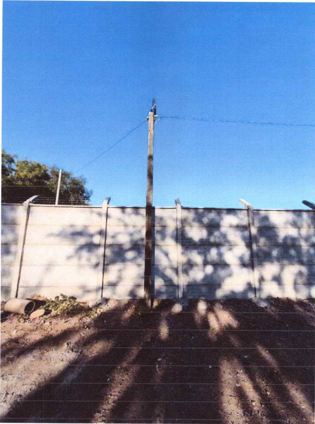
IMAGEN 36: SIN ITEM: REINTALACION DE POSTE PARA SOPORAT RED PUBLICA QUE ALIMENTA LUMINARIAS QUE APUNTAN HACIA SITIO ERIAZO ADYACENTE A LA PANDERETA TRASERA DE LOS BAÑOS.
