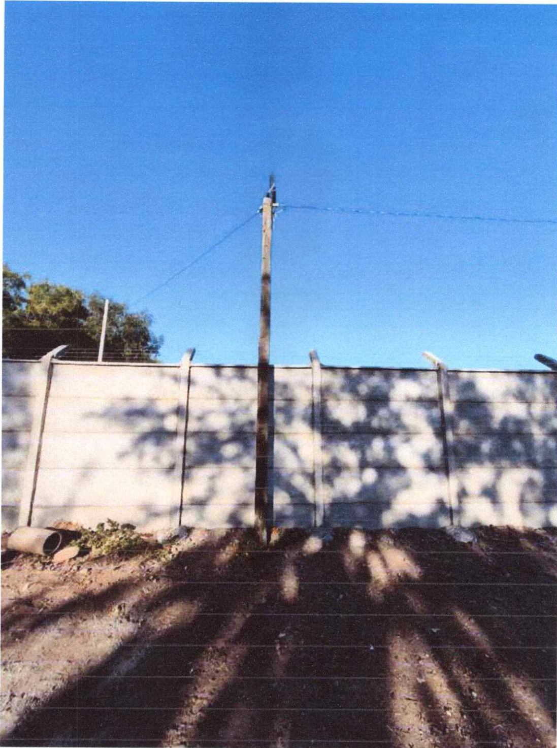
IMAGEN 36: SIN ITEM: REINTALACION DE POSTE PARA SOPORAR RED PUBLICA QUE ALIMENTA LUMINARIAS QUE APUNTAN HACIA SITIO ERIAZO ADYACENTE A LA PANDERETA TRASERA DE LOS BAÑOS.
