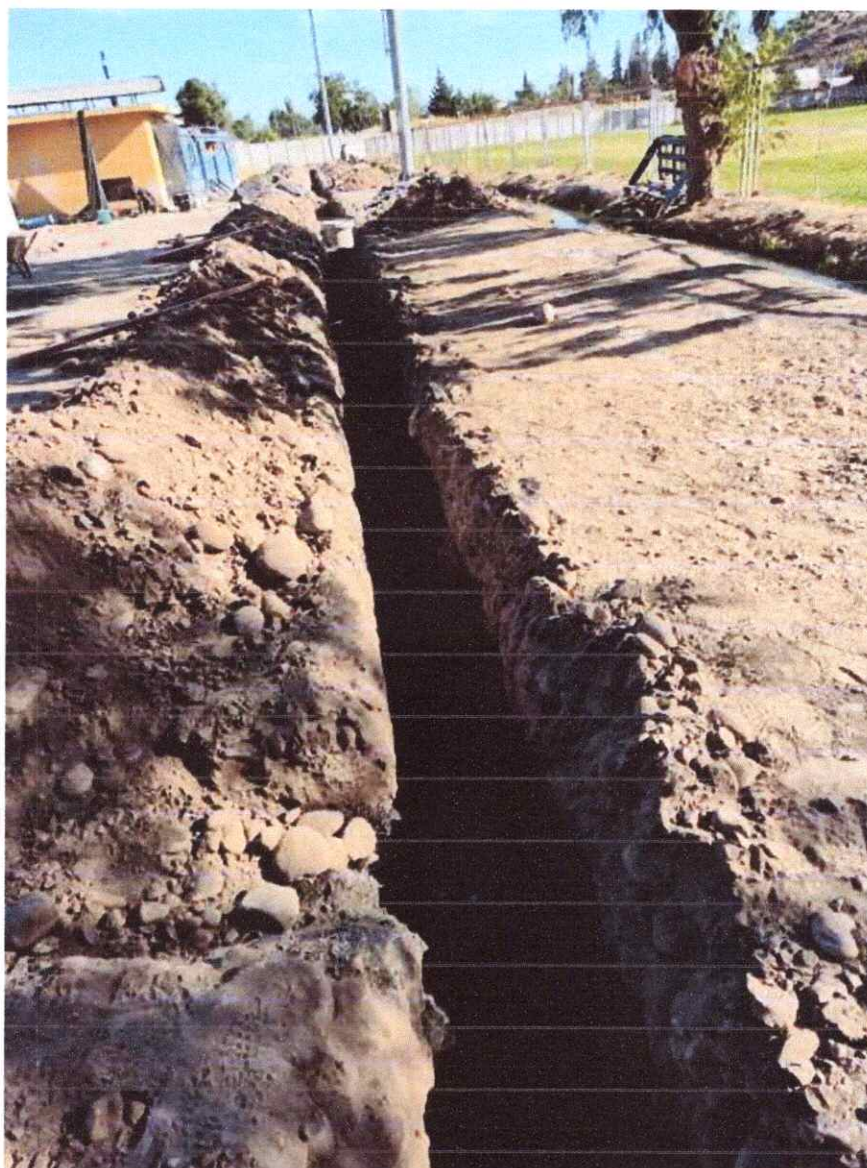
IMAGEN 27:ITEM 4.3 INSTALACION ELECTRICA.
