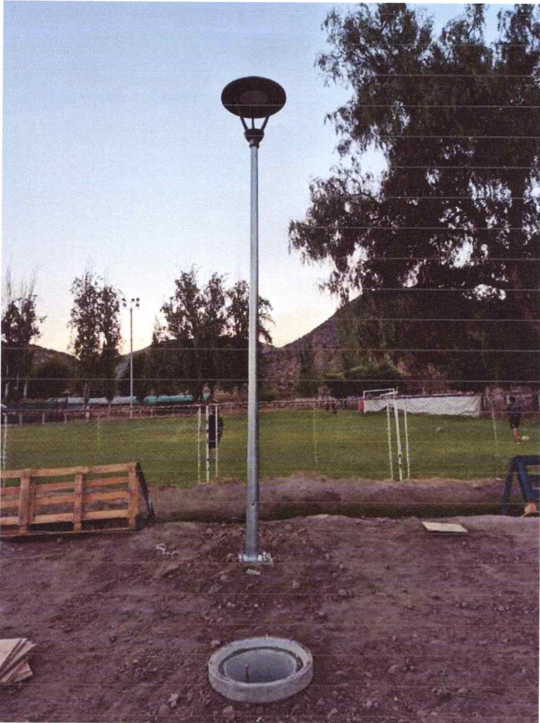
IMAGEN 30:ITEM 4.3 INSTALACION ELECTRICA.
