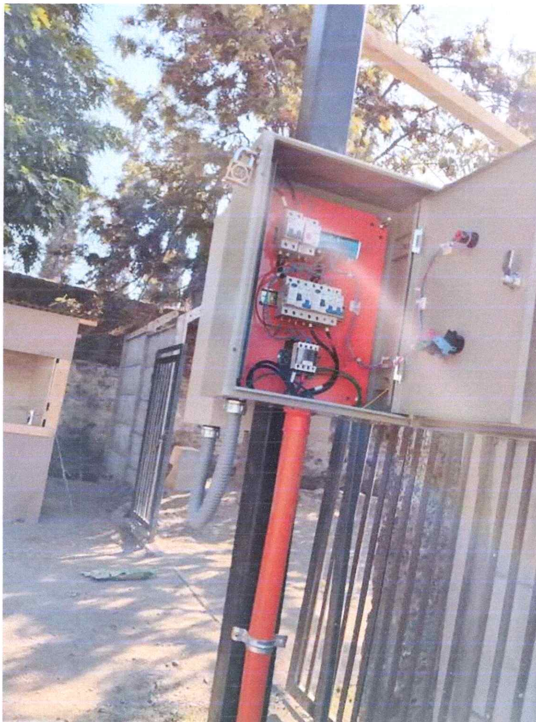
IMAGEN 25:ITEM 4.3 INSTALACION ELECTRICA.
