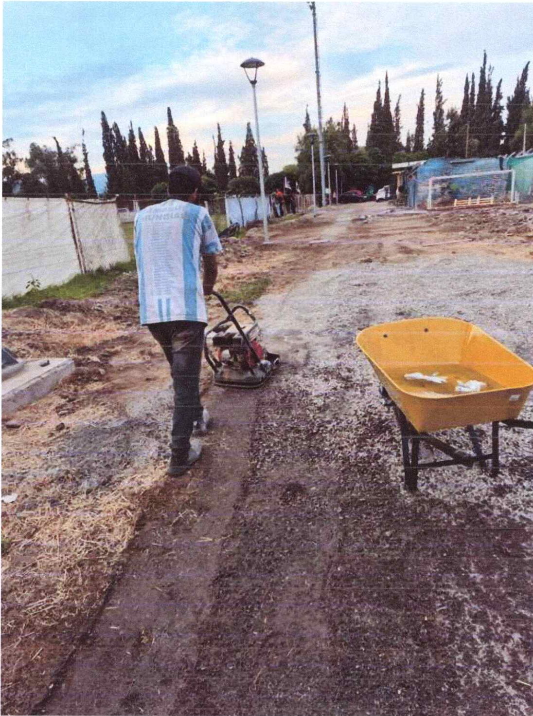
IMAGEN 31:ITEM 4.3 INSTALACION ELECTRICA.
