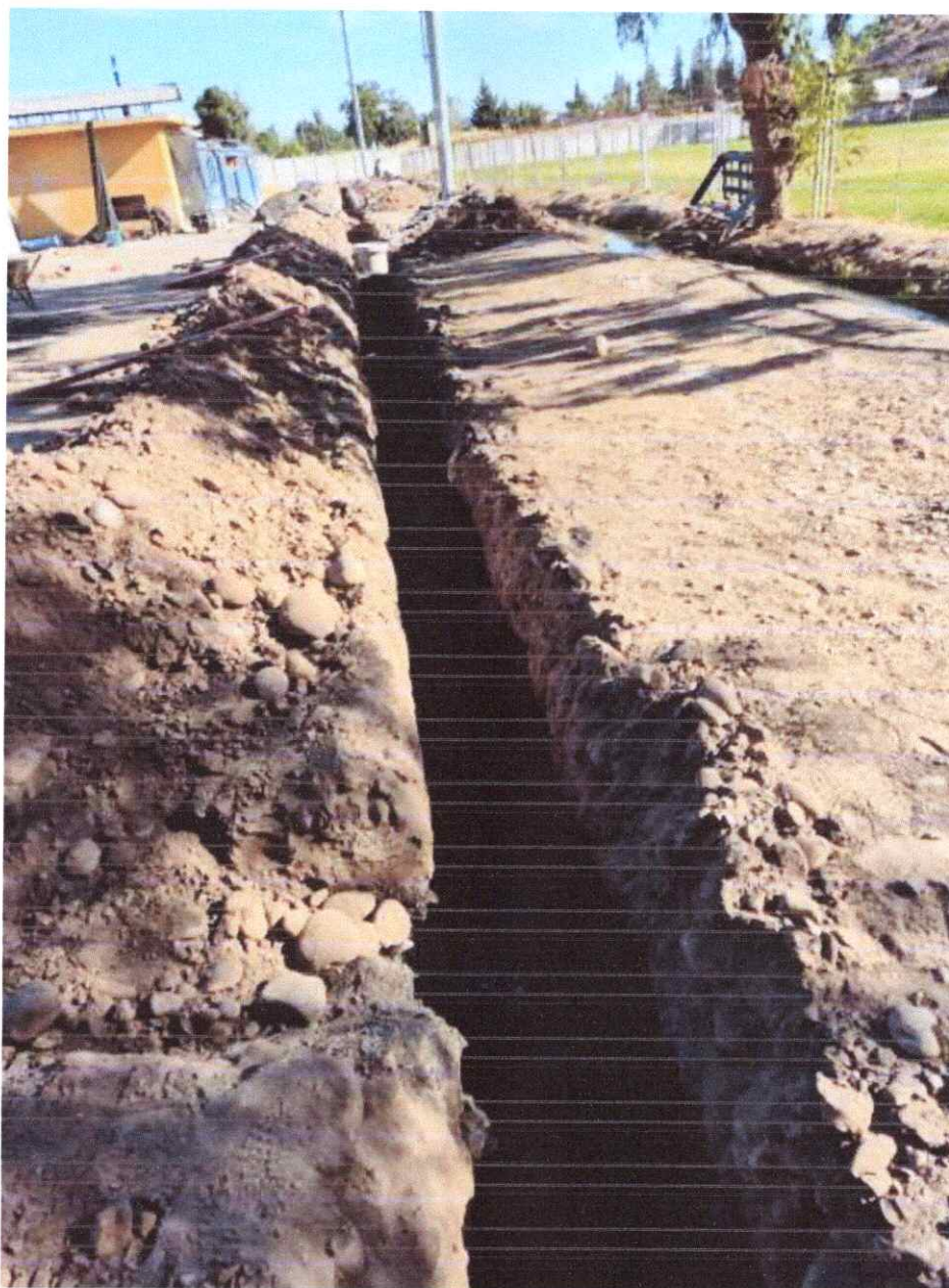
IMAGEN 27:ITEM 4.3 INSTALACION ELECTRICA.
