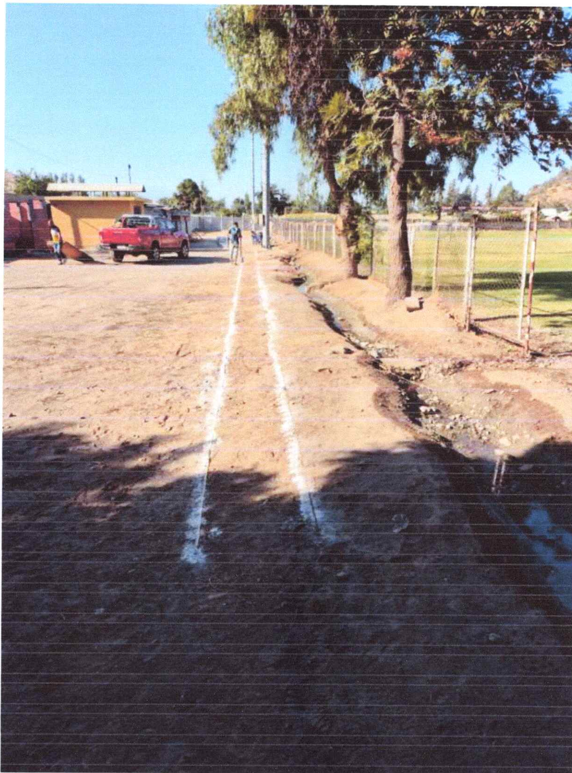
IMAGEN 26:ITEM 4.3 INSTALACION ELECTRICA.
