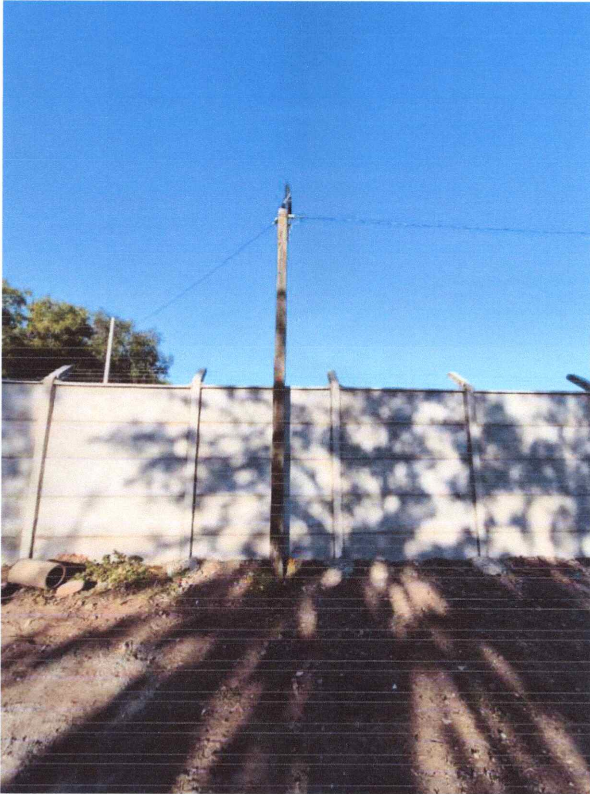
IMAGEN 36: SIN ITEM: REINTALACION DE POSTE PARA SOPORAR RED PUBLICA QUE ALIMENTA LUMINARIAS QUE APUNTAN HACIA SITIO ERIAZO ADYACENTE A LA PANDERETA TRASERA DE LOS BAÑOS.
