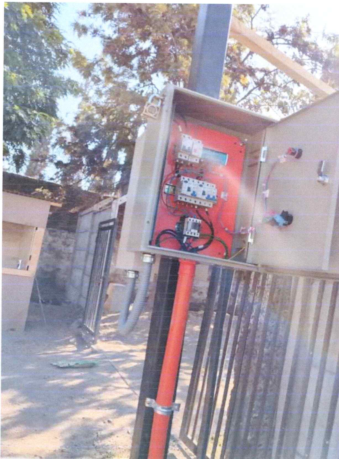
IMAGEN 25:ITEM 4.3 INSTALACION ELECTRICA.
