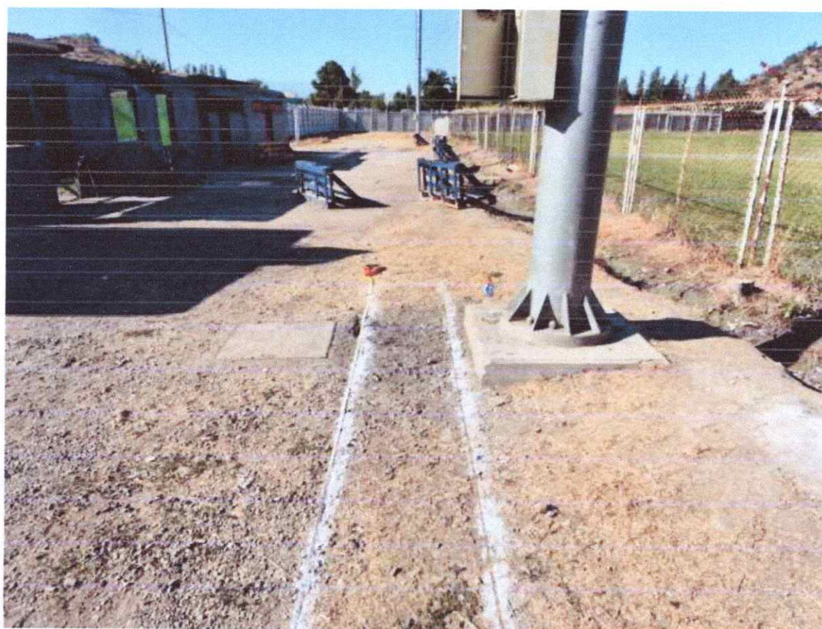
IMAGEN 28:ITEM 4.3 INSTALACION ELECTRICA.
