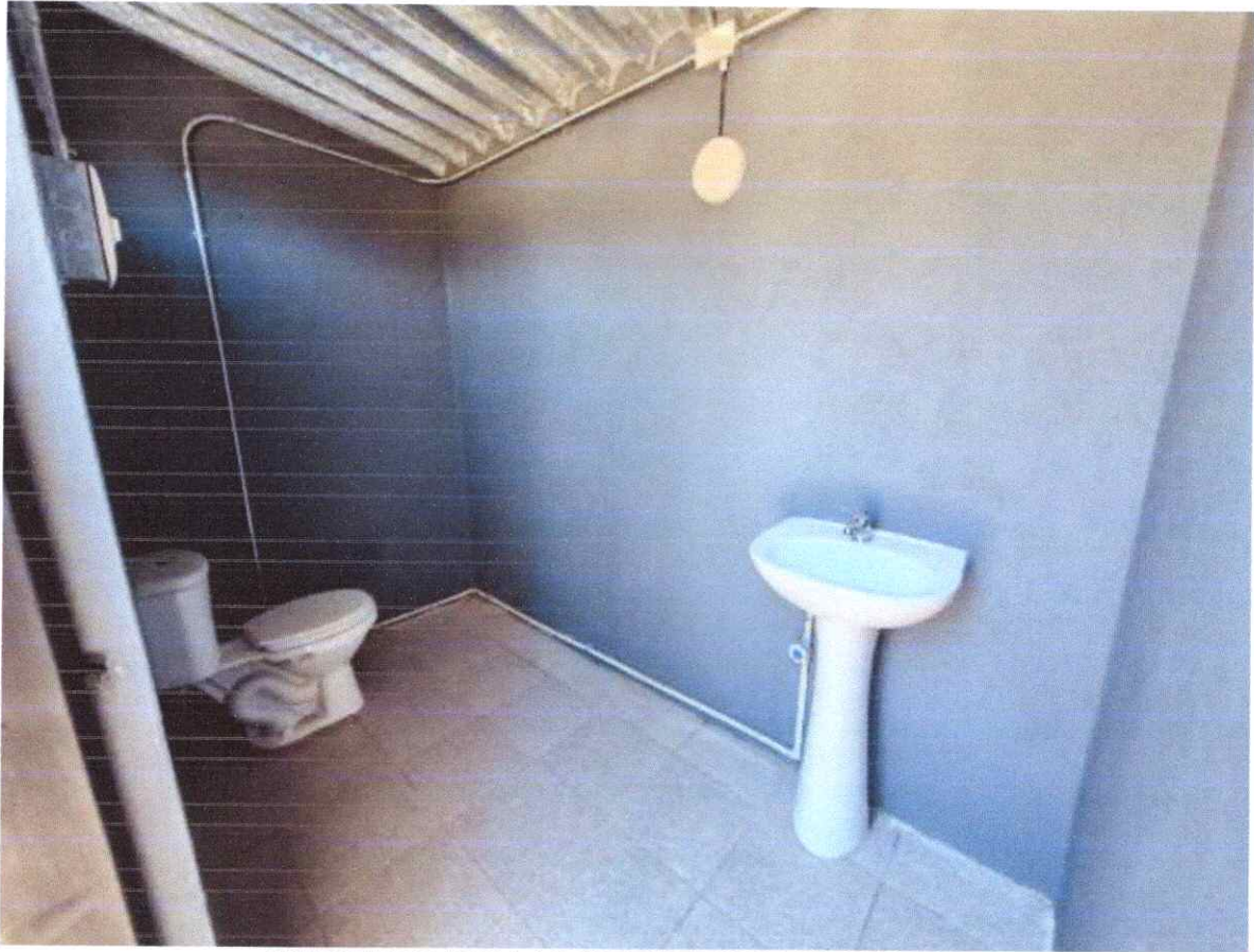
IMAGEN 32:ITEM 4.3 INSTALACION ELECTRICA.
