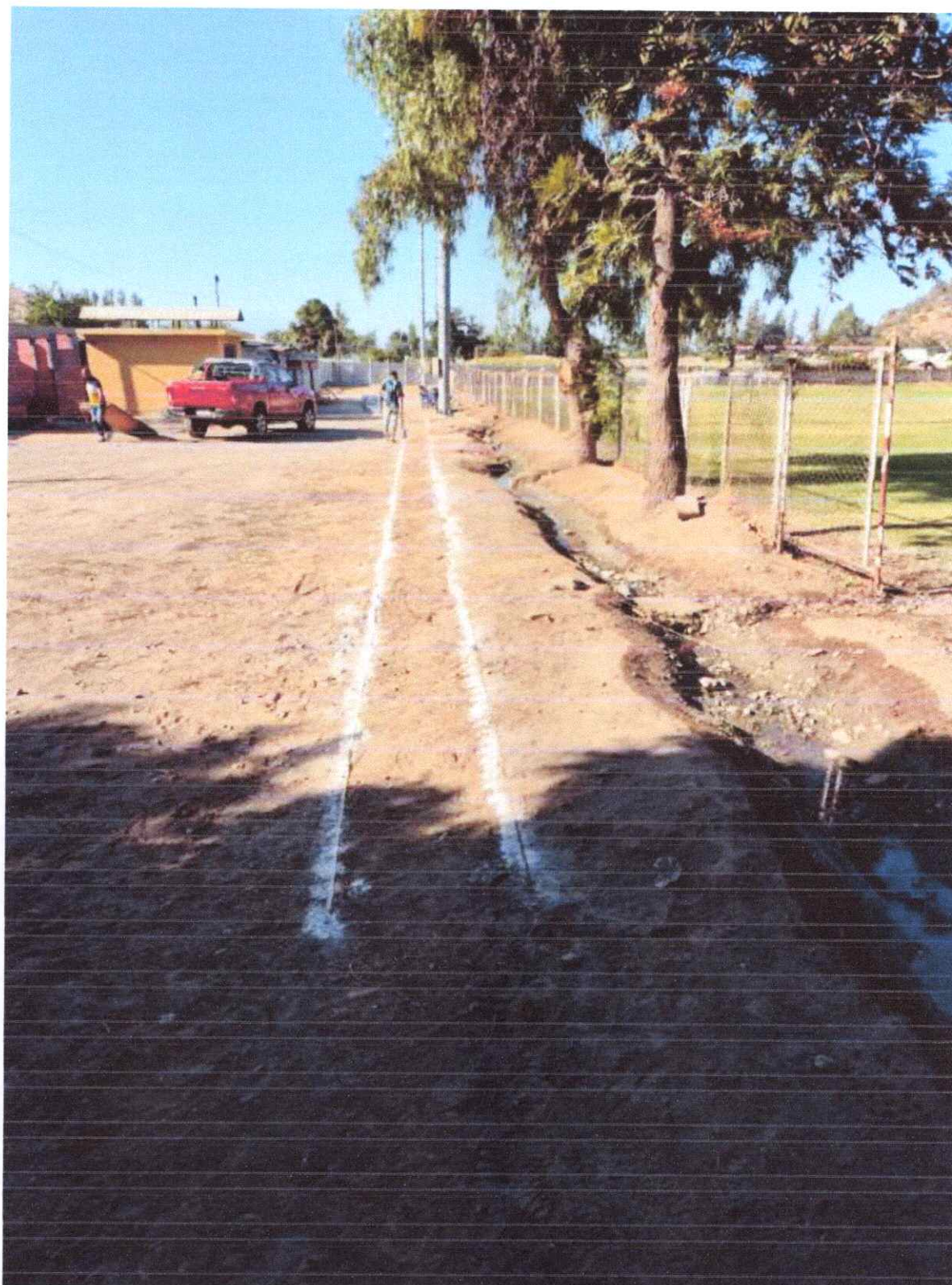
IMAGEN 26:ITEM 4.3 INSTALACION ELECTRICA.
