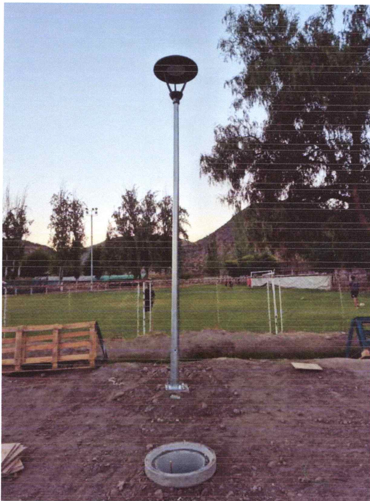
IMAGEN 30:ITEM 4.3 INSTALACION ELECTRICA.
