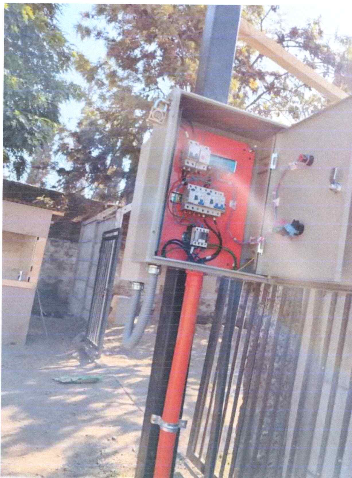
IMAGEN 25:ITEM 4.3 INSTALACION ELECTRICA.
