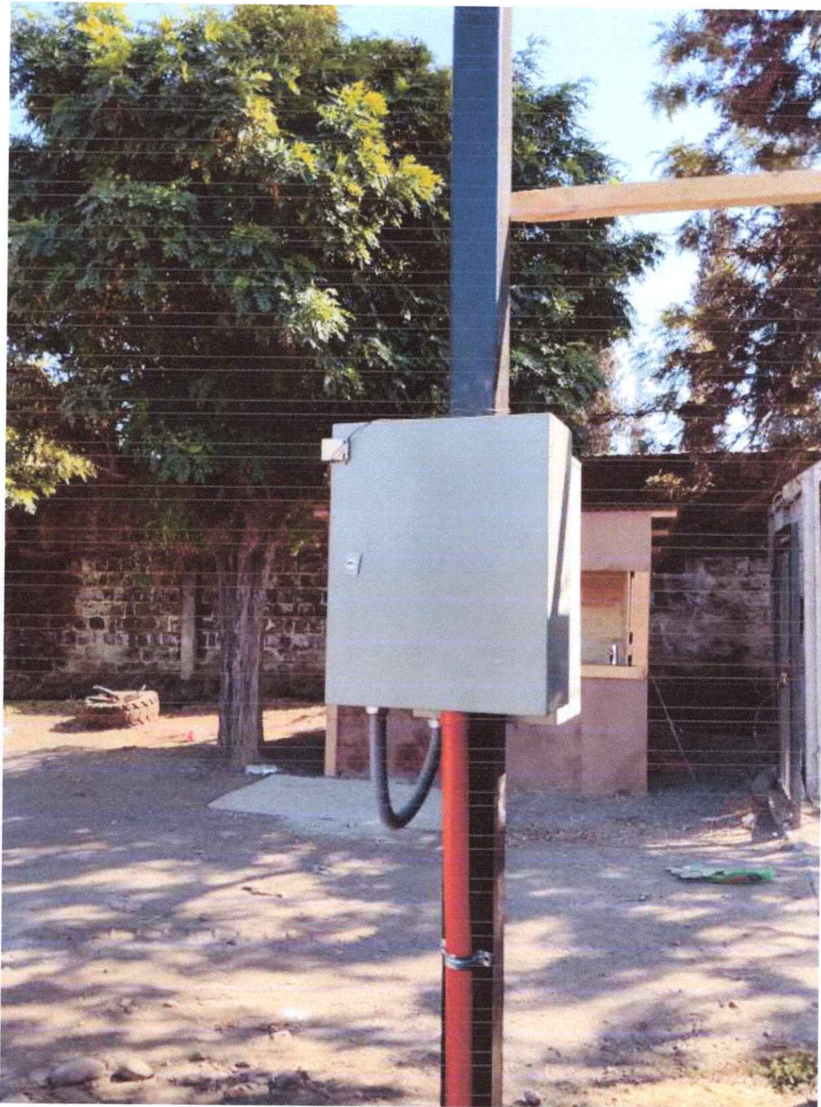
IMAGEN 24:ITEM 4.3 INSTALACION ELECTRICA.
