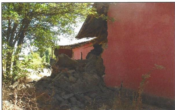
SITUACIÓN POST TERREMOTO
