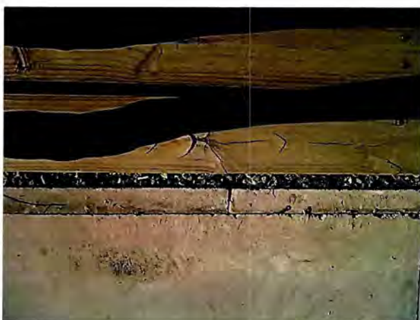
Fotografía N°33: Detalle de piezas de madera con defectos.
