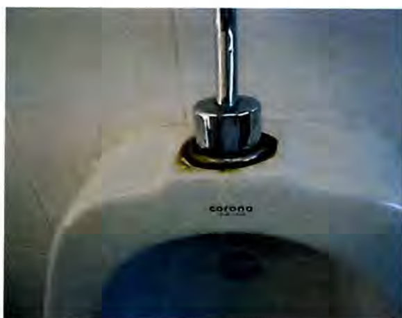
Fotografía N°2: Vista de artefacto sanitario con filtraciones.
