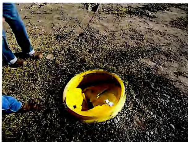
Fotografía N°6: Detalle de tapa de cámara dañada.
