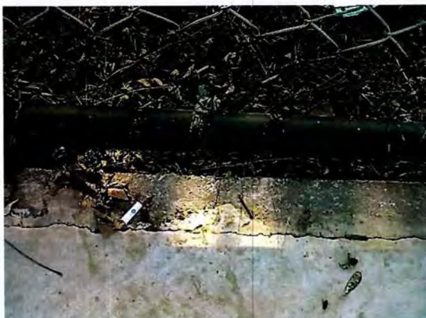
Fotografía N°16: Detalle del estado de reja metálica.
