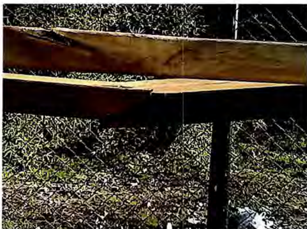
Fotografía N°30: Elemento constructivo dañado.
