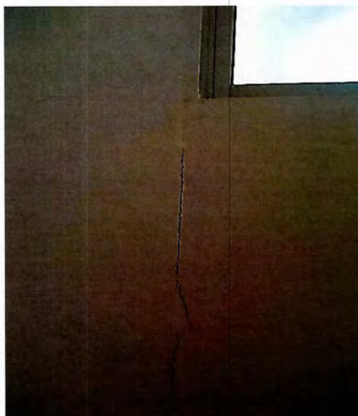
Fotografía N°24 Detalle de fisuras en paramentos verticales.
