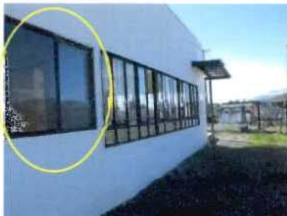
Fotografía N° 02: Detalle de ventana en Sala de Mudar sin instalación de protección metálica antirrobo.
