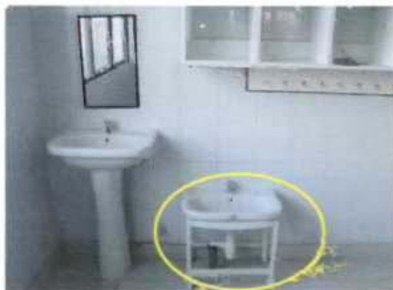
Fotografía N° 06: Detalle de atril de lavamanos de niños instalado en sala de mudas del establecimiento.
